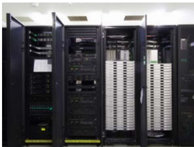
サーバールームにあるKAISERの中核部分
