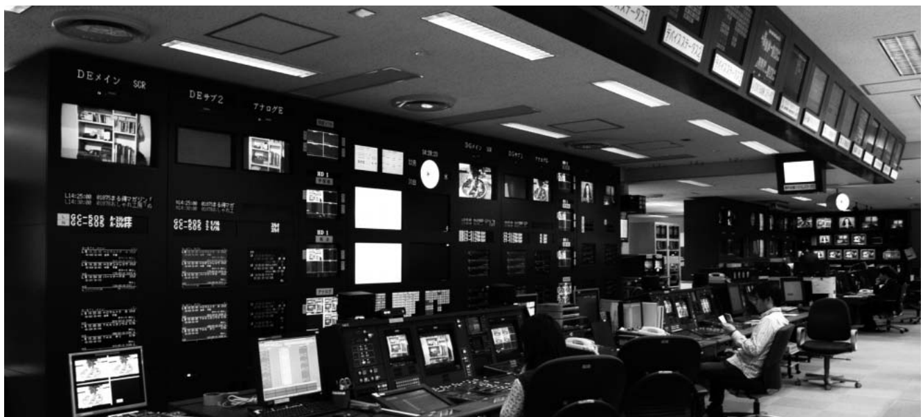
写真1. デジタル地上放送設備のフロア全景
