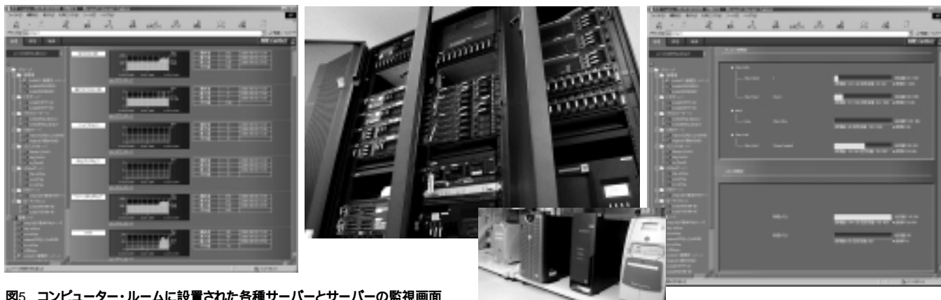
図5. コンピューター・ルームに設置された各種サーバーとサーバーの監視画面
