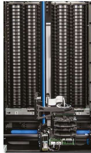
La biblioteca de cintas IBM TS4500 por dentro
